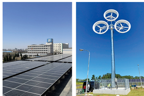
画像参照：工場に設置した太陽光パネルと風力発電 (YKK APのHPより)
