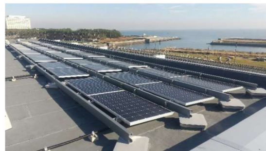
画像参照：マンションの屋上に設置した太陽光パネル (三菱地所レジデンス・プレスリリースより)
